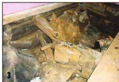
Вскрытие показало, что лаги полностью сгнили. Надо устанавливать новые.
