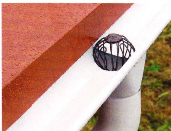
Для предотвращения засорения водосточной трубы листьями и иным мусором в воронки устанавливают специальные сетки — «пауки».
